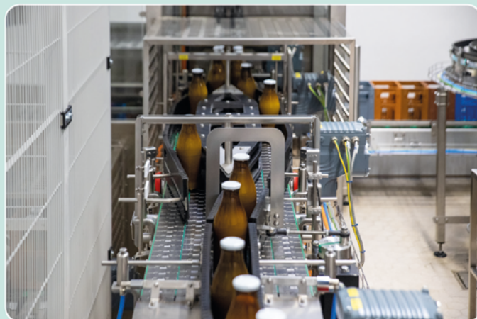
Testlauf der neuen Glasabfüllanlage im Neubau.
